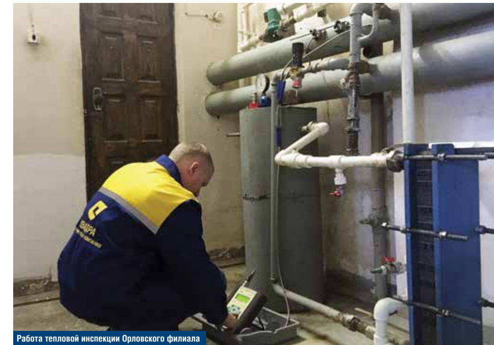
Работа тепловой инспекции Орловского филиала
